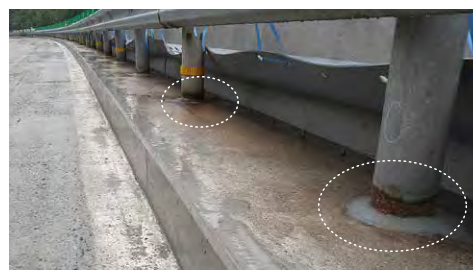
ガードレール足元「マクロセル腐食」
