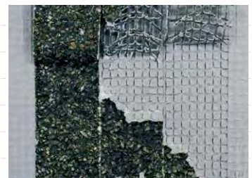
アクアベースと改質アスファルト界面剥離
