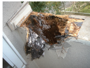
ベランダ笠木取合い部からの漏水・腐朽例
