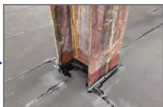
底部ゴムロンフォルトM (改質アスファルトシート)貼り込み
