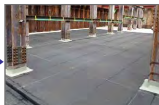
中間杭部の改質アスファルト系 塗膜防水併用処理 [完了]
