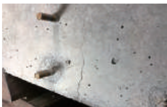
ひび割れの状況
