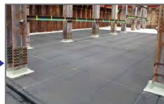
中間杭部の改質アスファルト系 塗膜防水併用処理 [完了]
