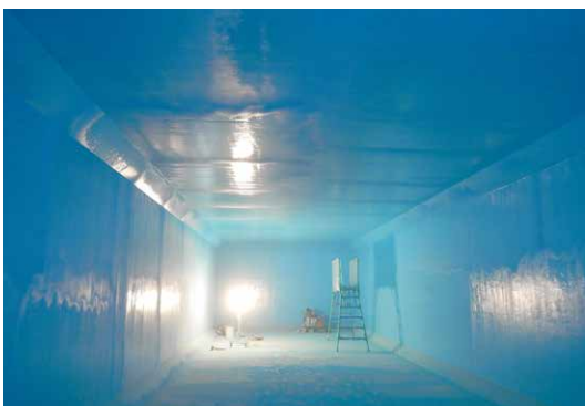
上水施設(浄水池)
