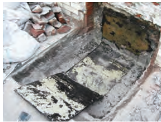
防水層切り取り
