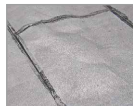
シート系防水層のフクレ
