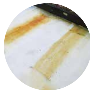
雨水等に起因する防水層表面汚れ
