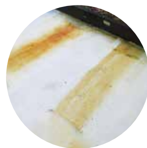
雨水等に起因する防水層表面汚れ
