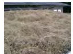
雑草が繁茂し植栽が被圧され衰退
