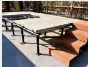
二重床の構造展示 ・ウッドデッキ階段 ・PCパネル
