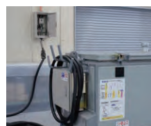
電源(200V)を活用した電気式
