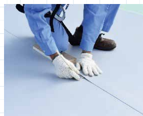
シートジョイント部を溶着剤を塗布し、専用の押え板で圧着
