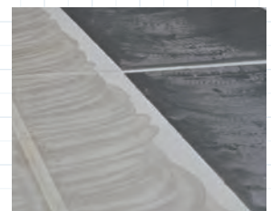
下地、シート裏面両方に接着剤が塗布されていることを確認
