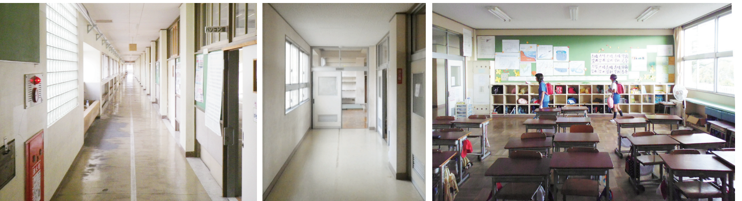
改修前の廊下と教室。よく清掃されていたが、老朽化が進み固い雰囲気だった。
