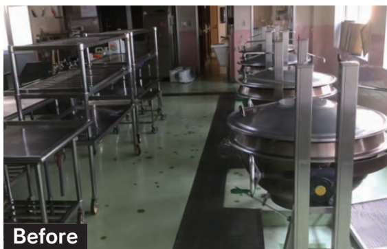
部分的に色褪せが見える湿式による改修前の塗り床仕上げの調理室。
